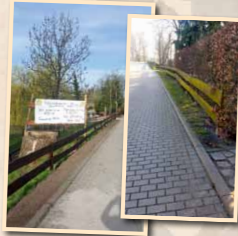
Etwa 70 Meter Holzzaun mit Pfosten wurden erneuert inklusive Lasuranstrich und Anfüllen mit Muttererde.
